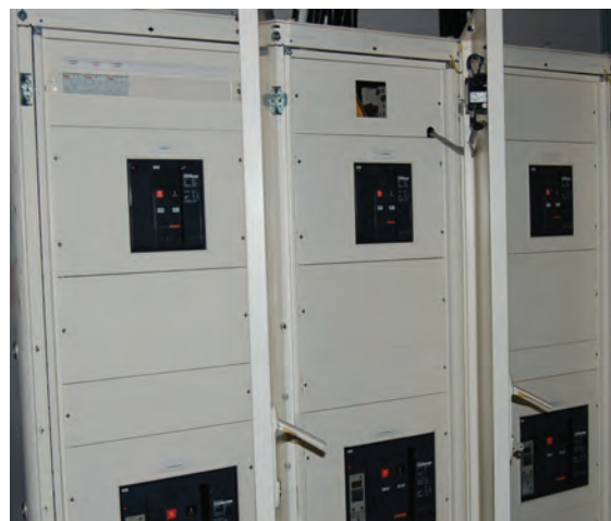
Tryb zasilania awaryjnego oparty jest na wykorzystaniu Systemu synchronizacji PowerCommand® PCC 3100
